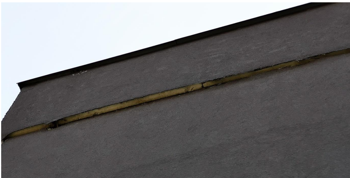
Fot.6 Elewacja zachodnia – przesunięcie ścianki kolankowej o około 9-10 cm. Które doprowadziło do ścięcia warstwy tynku mineralnego
