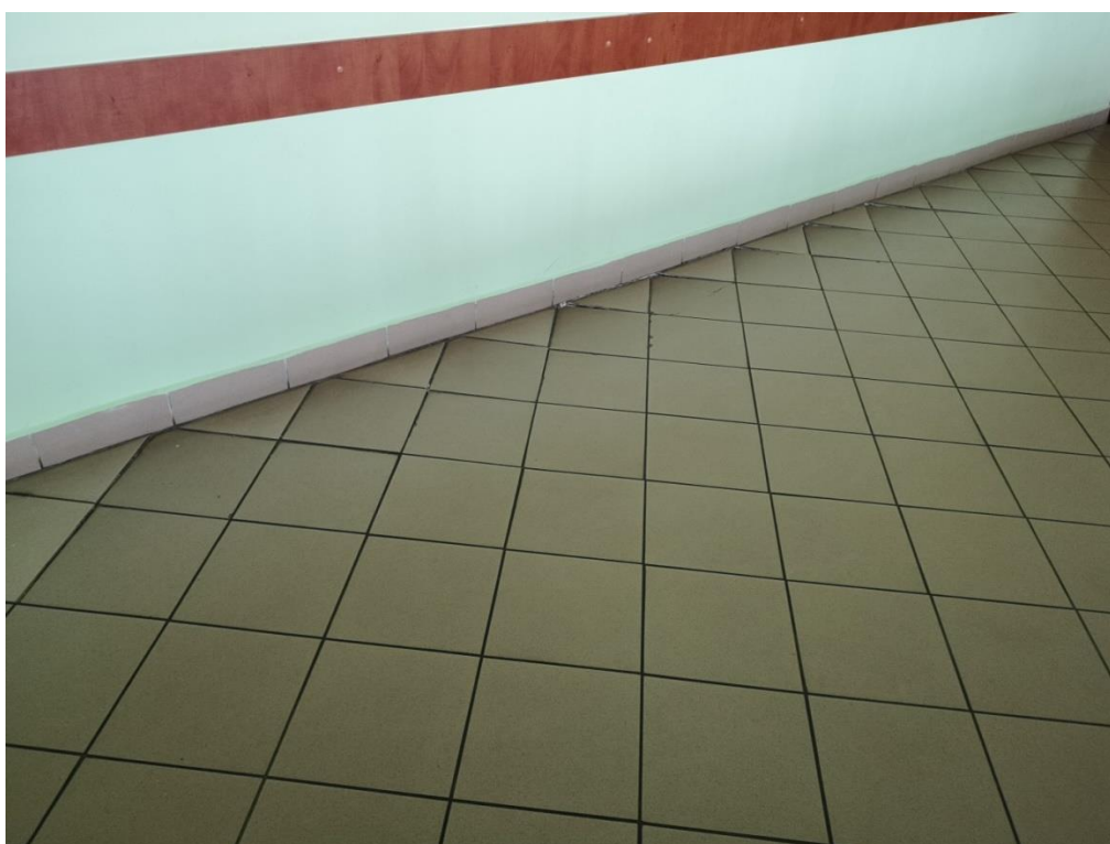
Fot.16 Opadnięcie podłogi o około 3-4 cm w pobliżu ściany działowej
