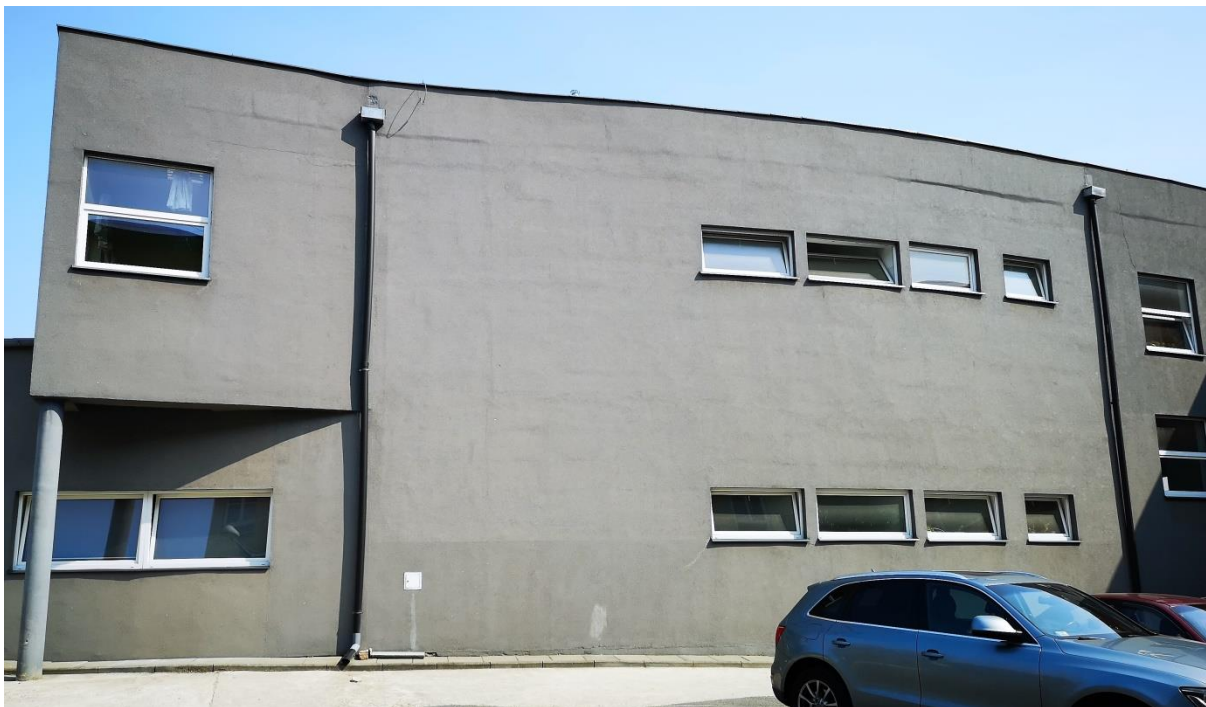
Fot.5 Widok elewacji południowej. Liczne nierówności i spękania powierzchni
