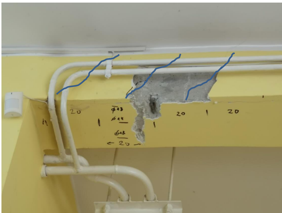
Fot.20 Rysy ukośne w strefie przypodporowej podciągu w auli
