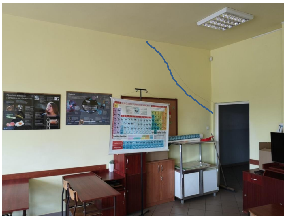
Fot.18 Ukośne pęknięcie ściany działowej w pomieszczeniu W16
