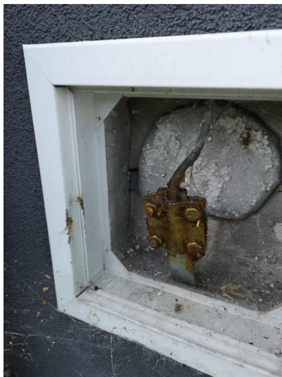
Fot.11 Widok placka kleju o grubości 11 mm w rewizji uziemienia od strony północnej
