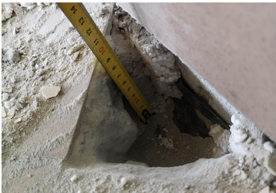
Fot.2 Odkrywka warstw stropu nad I piętrzem; widoczna 8 cm warstwa szlichty cementowej i nieprawidłowo umieszczona folia PE pod styropianem
