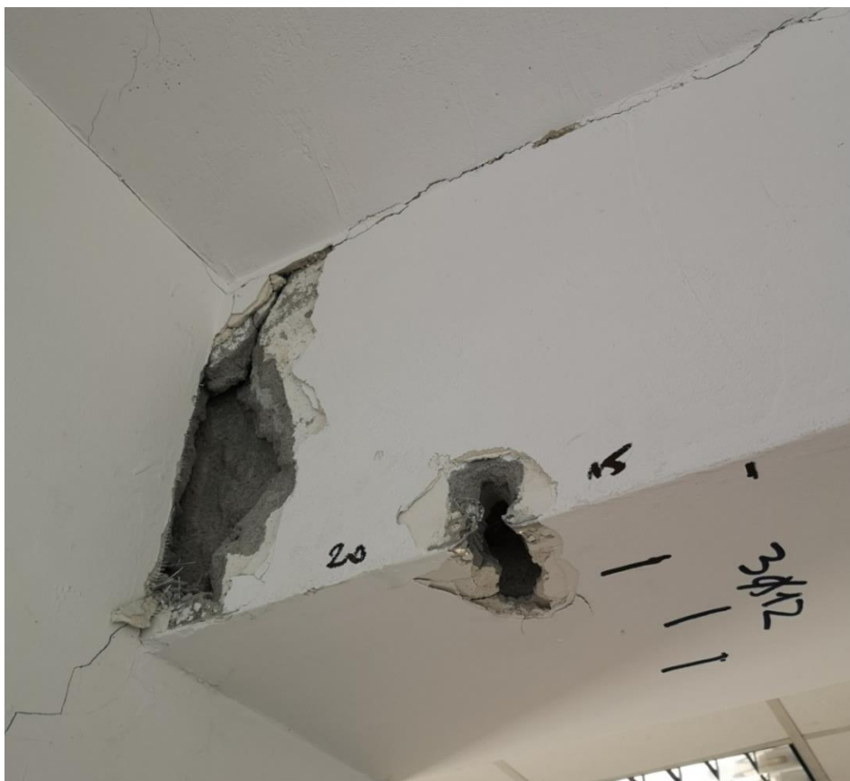
Fot.23 Warstwa grubej obrzutki cementowej, która uległa odspojeniu; widoczne rozstawy strzemion
