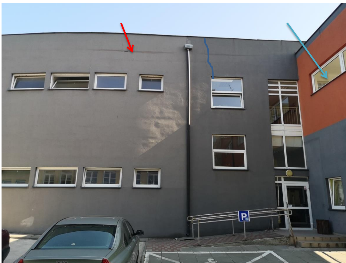
Fot.4 Widok elewacji od strony południowej. Widoczna nierówna powierzchnia ściany. Czerwoną strzałką zaznaczono miejsca potencjalnego przemieszczenia ścianki attykowej. Niebieską strzałką zaznaczono zarysowaną belkę stropu nad I piętrem przy łączniku
