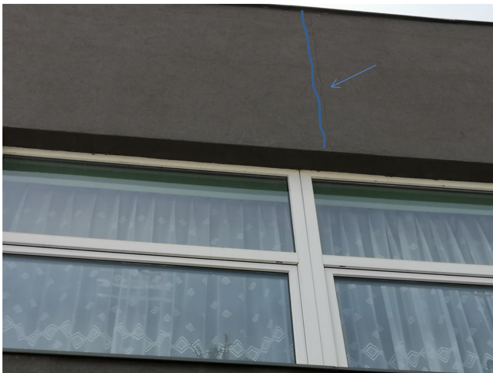
Fot.9 Pionowe pęknięcie tynku mineralnego na elewacji północnej
