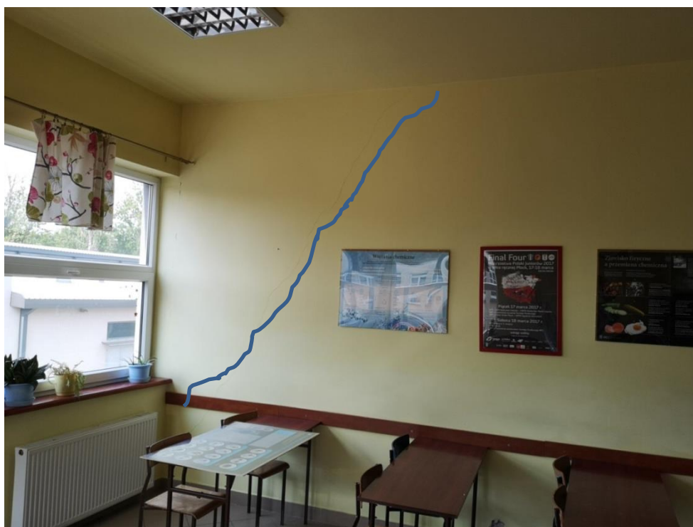
Fot.17 Ukośne pęknięcie ściany działowej w pomieszczeniu W16
