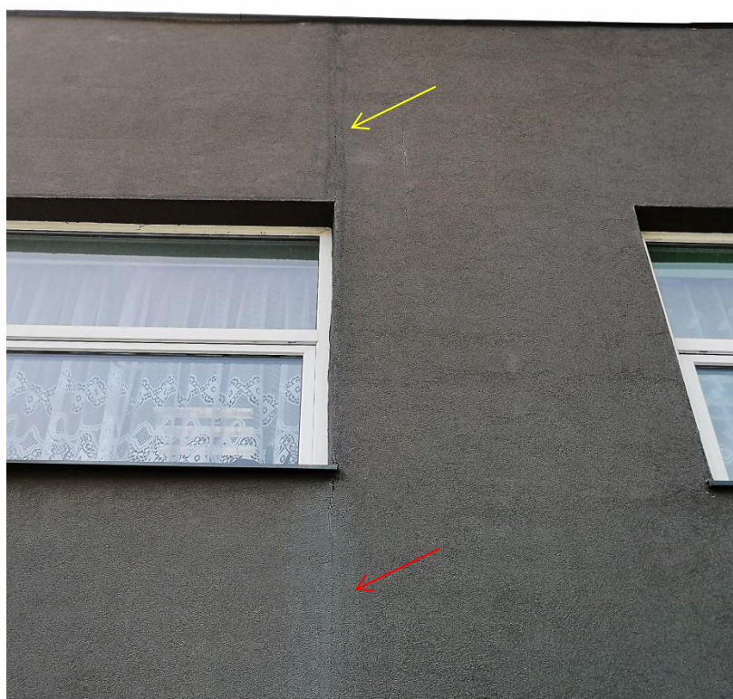
Fot.10 Pionowe pęknięcia tynku mineralnego na elewacji północnej. Czerwoną strzałką oznaczono rysę naprawianą
