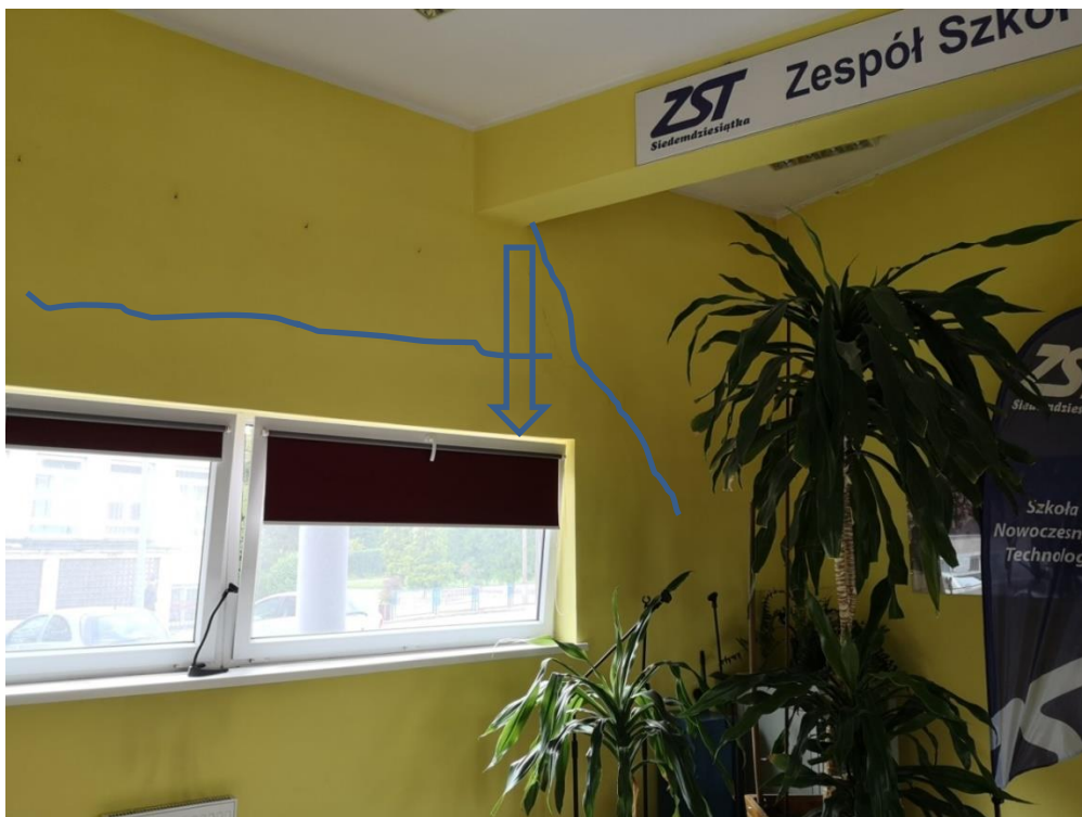
Fot.21 Zarysowanie ściany południowej auli spowodowane błędnym oparciem podciagu na ścianie południowej
